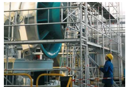
Réalisation pour la société de turbines gaz General Electric (90)
