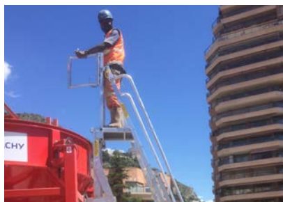
Accès nettoyage trémie
